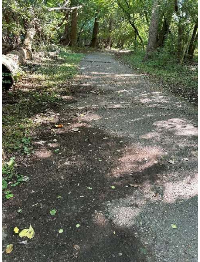
HMA Edge Deterioration
