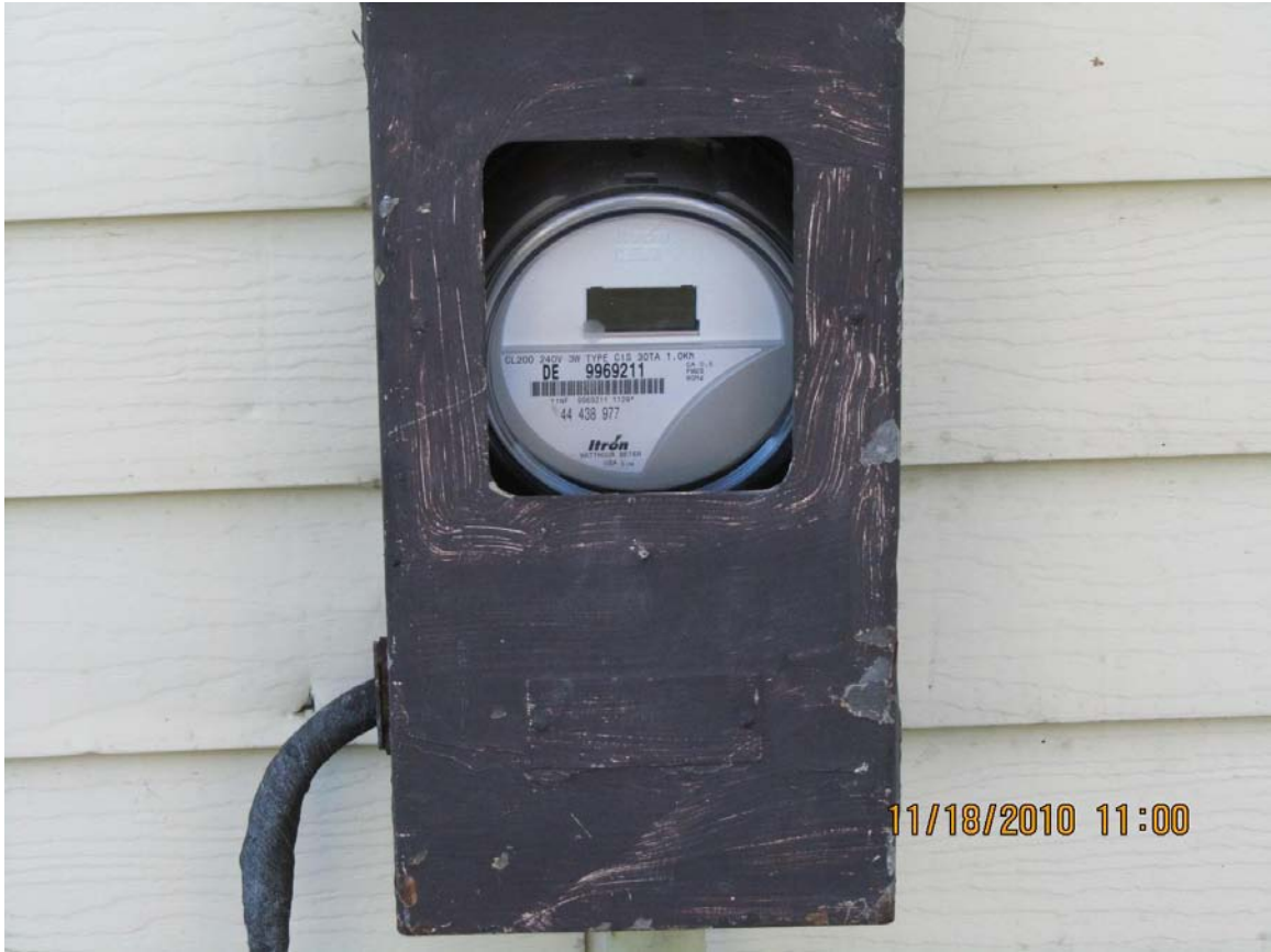
NON FUNCTIONING DTE METER
